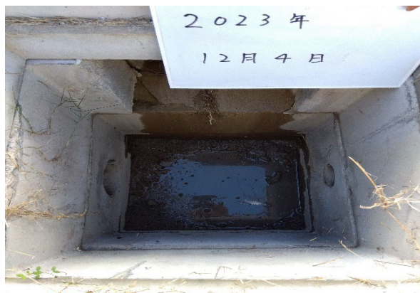
最終集水桝（場内）
