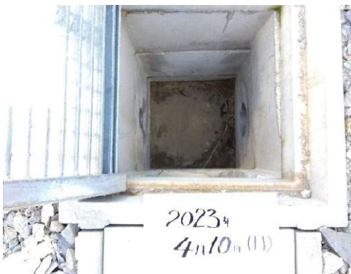
最終集水桝（場内）
