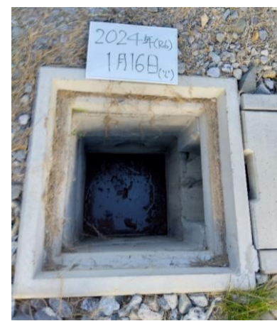
最終集水桝 (場内)
