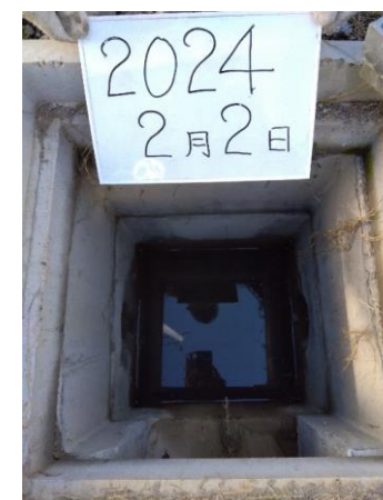
最終集水桝 (場内)
