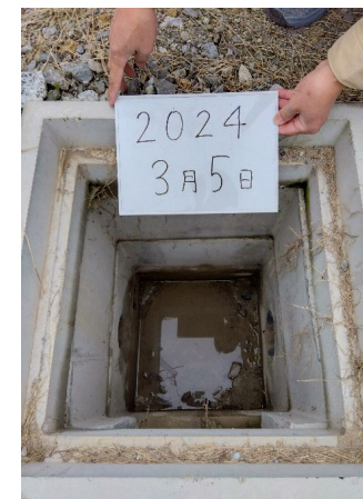
最終集水桝 (場内)
