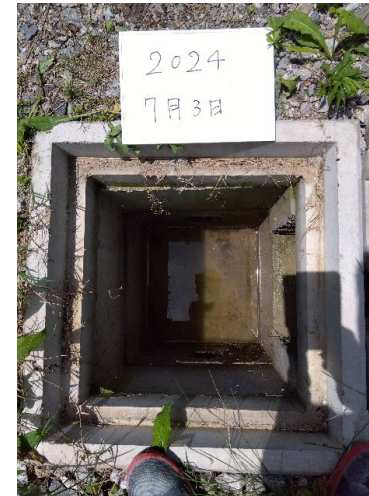
最終集水桝 (場内)
